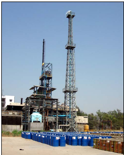
Luftforbrændingsanlæg på produktionsanlæg for mellemprodukter i Panoli.
