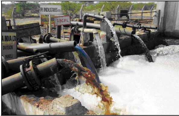
Pumpestation fra Panoli industriområde til det fælles biologiske rensningsanlæg.
